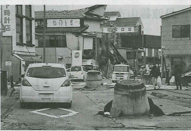
地震の影響で地面から隆起したマンホール=石川県輪島市で
